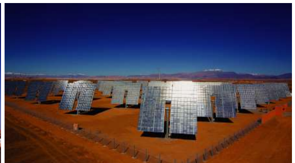
CENTRALE SOLAIRE CPV 1MWC À OUARZAZATE
