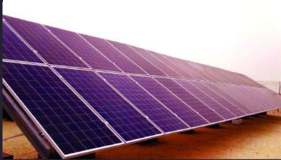
CENTRALE PV POUR VILLAGE DE PÊCHEURS AU SUD DE DAKHLA
