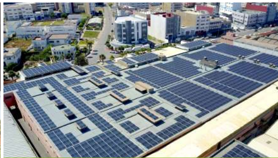
CENTRALE SOLAIRE EN TOITURE DE SOFTGROUP
